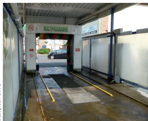
Aire de lavage de véhicules
