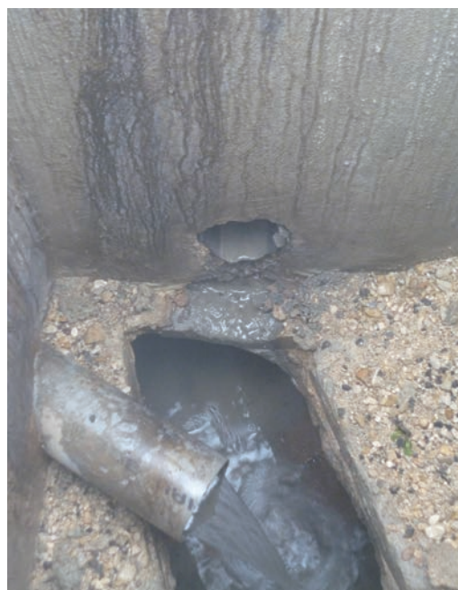
Rejet des eaux de lavage pré-traitées au réseau d'assainissement
