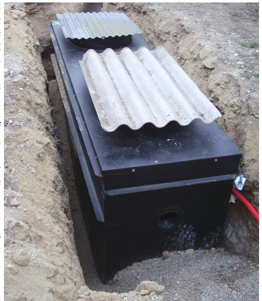
Installation d'un déboureur-déshuileur
