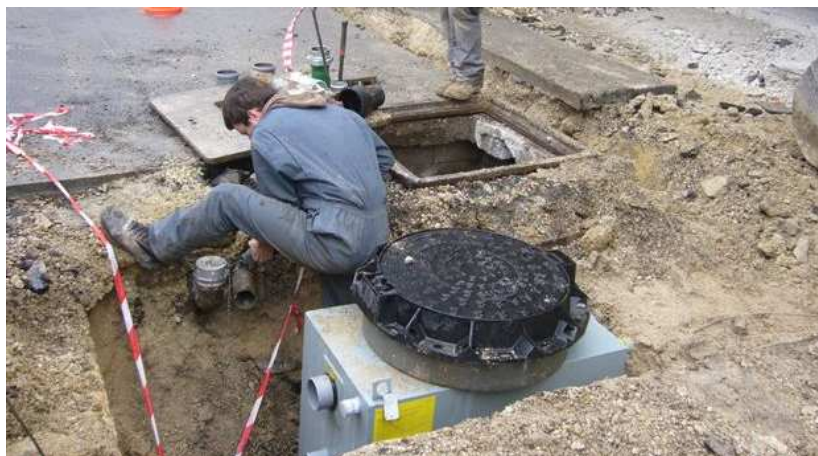
Installation d'un déboureur-déshuileur
