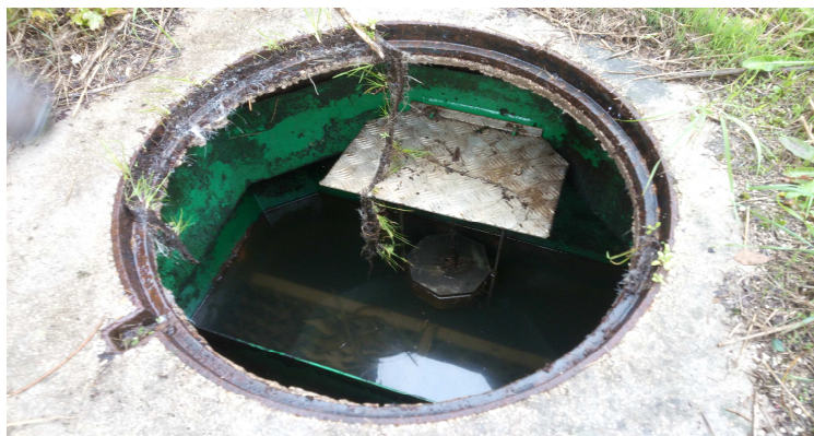
Déboureur-déshuileur sur une aire de lavage
