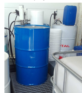
Sécurisation de stockage financé par l'Agence de l'eau
